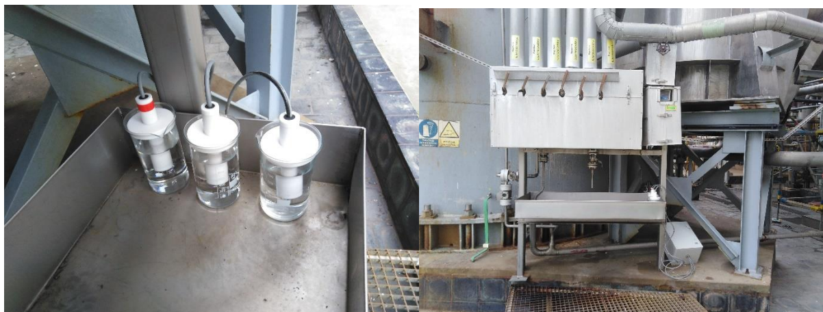
Obr. 7. Instalace sond na drenáži absorbéru v Lovochemii a.s.
